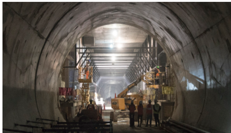
Ein im Bau befindlicher U-Bahn-Tunnel in Lima (Peru), der zu einem sichereren und nachhaltigeren Verkehrssystem beitragen soll.
